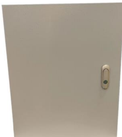
Rozdzielnica oświetlenia ROP-04M
